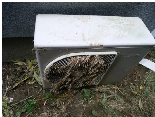
エアコン室外機被害 (提供：尾引壯一 氏)
