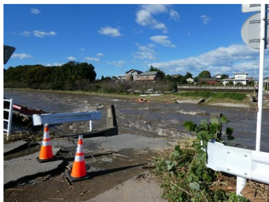
写真IV-8 川田橋落橋流失現場（2）
