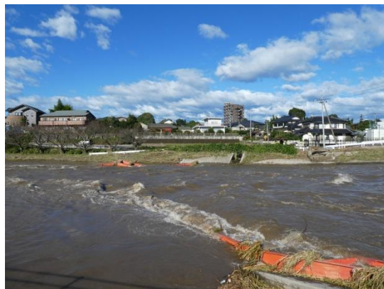
写真IV-7 川田橋落橋流失現場（1）
