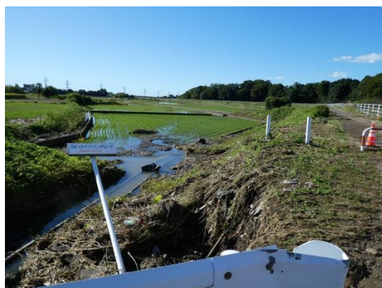
写真IV-9 川田橋付近の洗堀痕と農地被害
